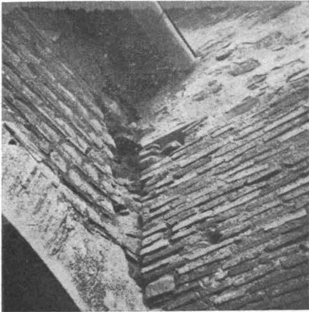
Fig. 38 — S. ANASTASIA — Fessura tra il muro sinistro superiore e il transetto Nord.
